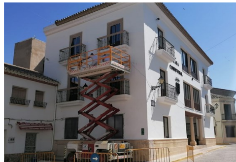
Obras eficiencia energética en el Ayuntamiento, Hogar del Jubilado y Vivienda Tutelada.
