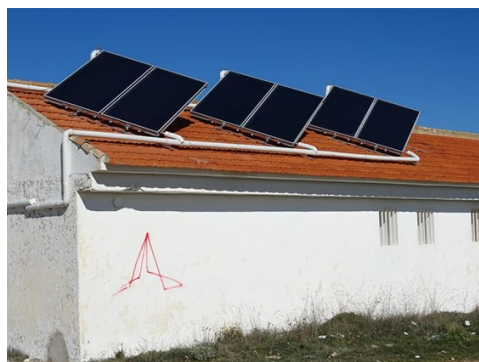
Instalación solar y nueva calefacción en el campo de fútbol municipal.
